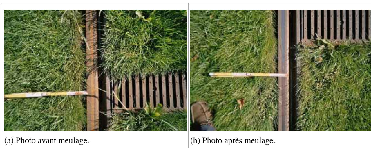
Figure 21 : Photo de rail de tramway avant et après meulage [22].
